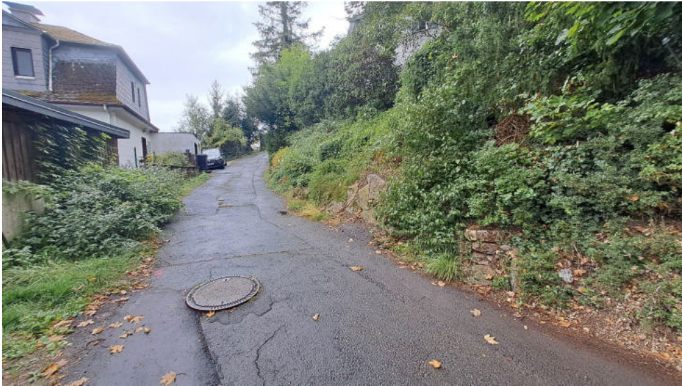
Abbildung 4: Schadhafte Asphaltfläche Anwesen Bergstraße 4, Blickrichtung Westen (Eigene Aufnahme)
