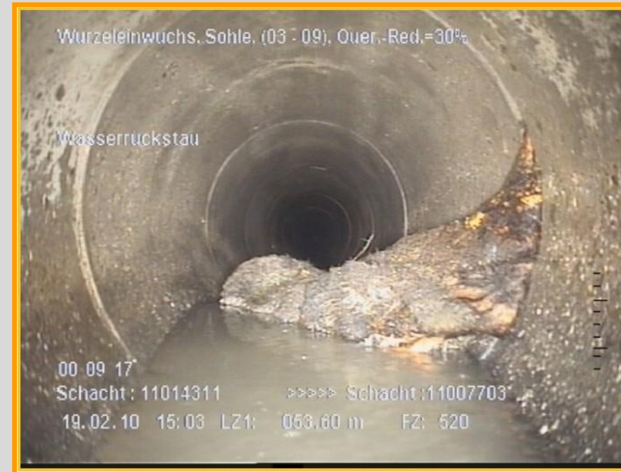
z. B.: starker Wurzeleinwuchs
