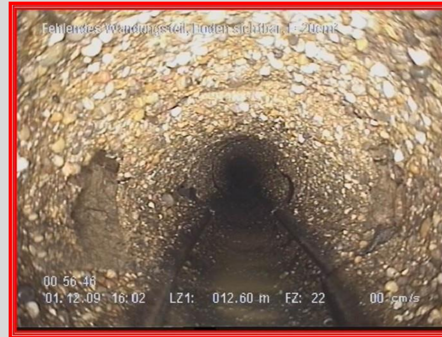
z. B.: fehlendes Wandungsteil, Innenkorrosion
