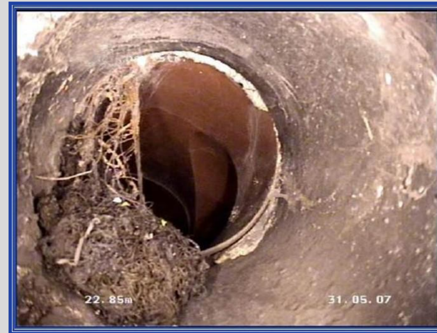
z. B.: Ablagerungen, Wurzeleinwuchs
