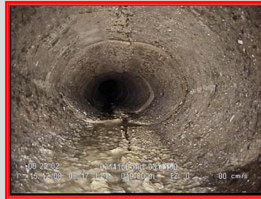
z. B.: statisches Rohrversagen, Querrisse + Längsrisse
