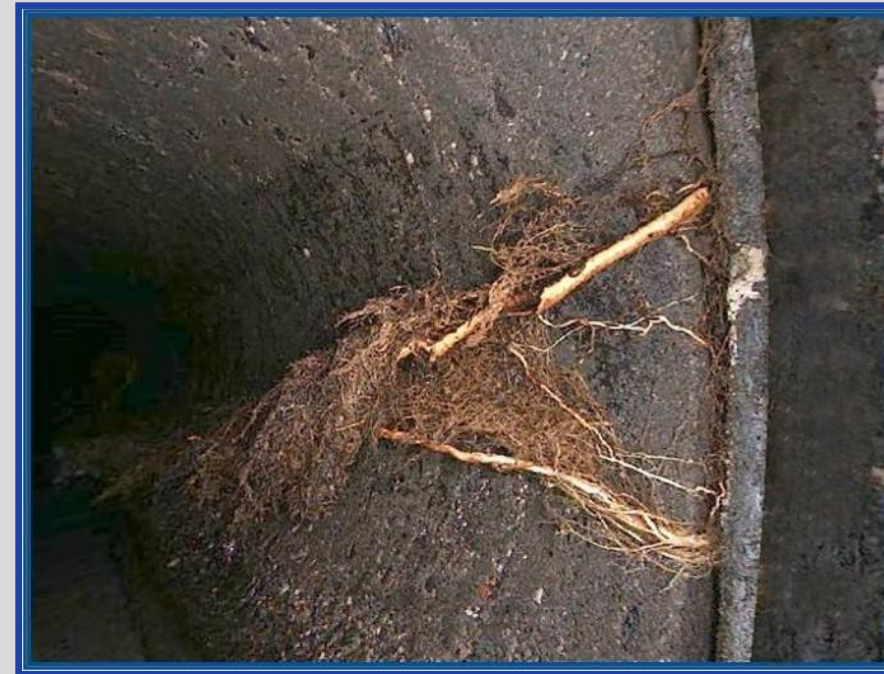
z. B.: Ablagerungen, Wurzeleinwuchs
